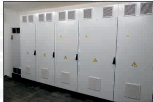
Hlavní rozvodna BČOV / main switch room
