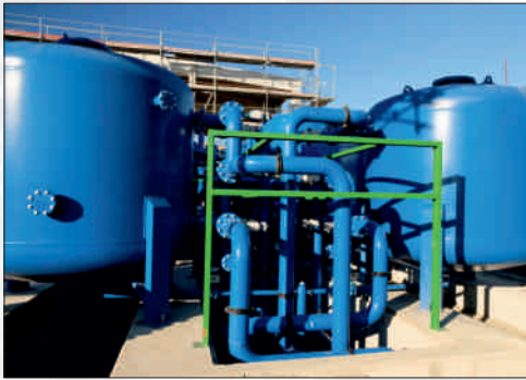
Filtrace písková a přes aktivní uhlí/ sand and activated charcoal filtration
