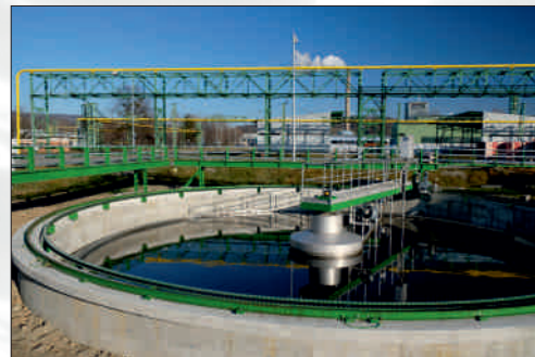
Dosazovací nádrž / secondary sedimentation tank
